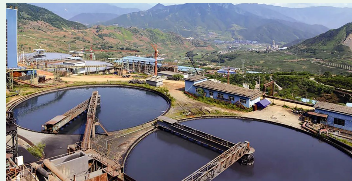
攀钢矿业新白马公司浓缩池
